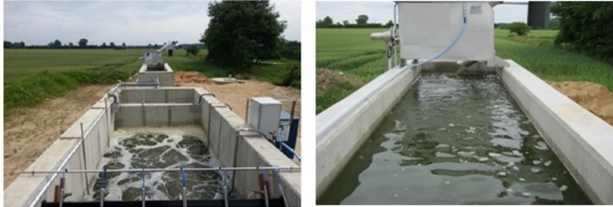
Deux bassins en béton facilement et rapidement connectés à la station de traitement des eaux usées entièrement fonctionnelle
